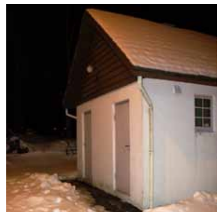
I Vikebygd fraus vassrøyrar sund på toaletta i bårhuset. Takk til Agnar og Øystein som kom til og fekk stengd stoppekranen.
